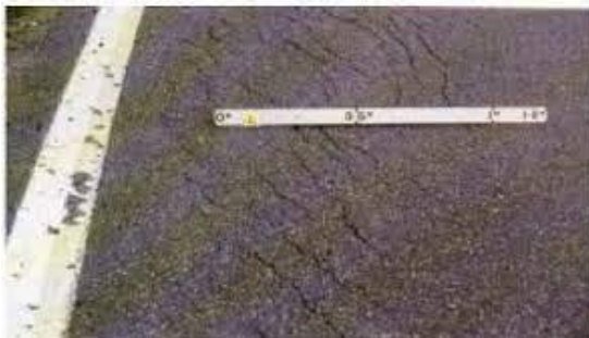
menunjukkan Slippage Cracking
